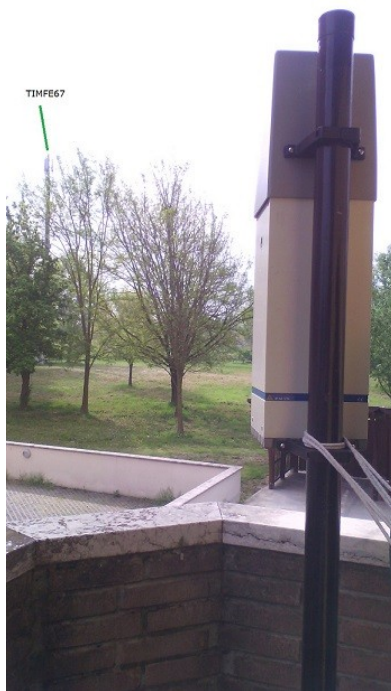
Centralina posta sul balcone esterno, 1° piano
